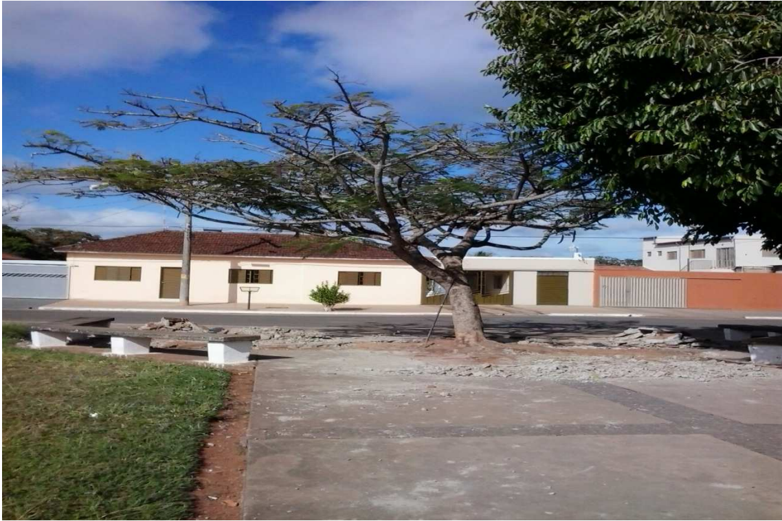
Figura 01: Vista geral do individuo arbóreo da espécie flamboyant, aonde suas raízes danificou a calçada.
