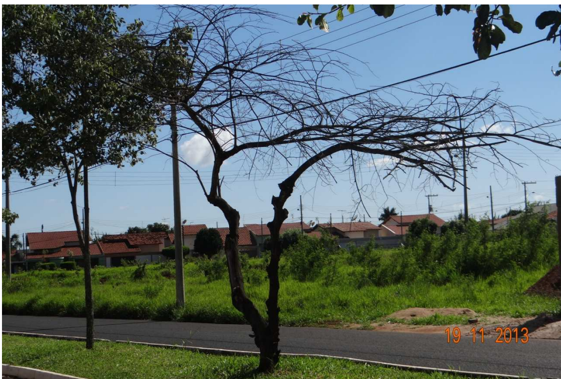
Figura 01: Foto de um indivíduo arbóreo morto da espécie aroeira salsa em frente à quadra de futebol na Avenida Santos Dumont.
