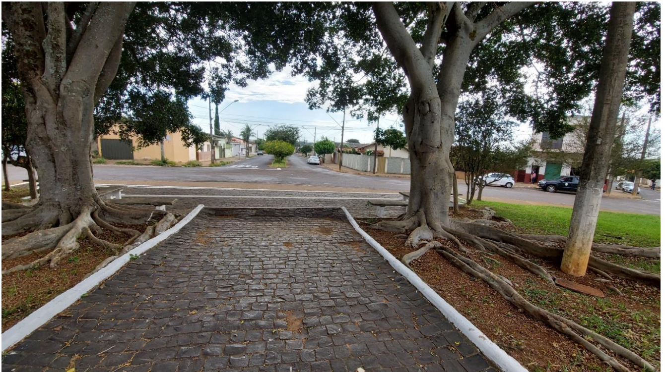
Foto 06: Raízes dos Ficus expostas, danificando a estrutura da Praça Valdomiro Barbosa
