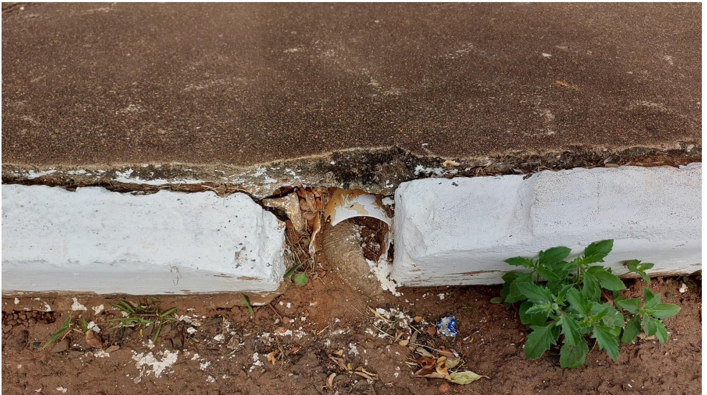
Foto 02: Raízes de uma das árvores invadindo a tubulação de drenagem da praça e avançando rumo ao asfalto
