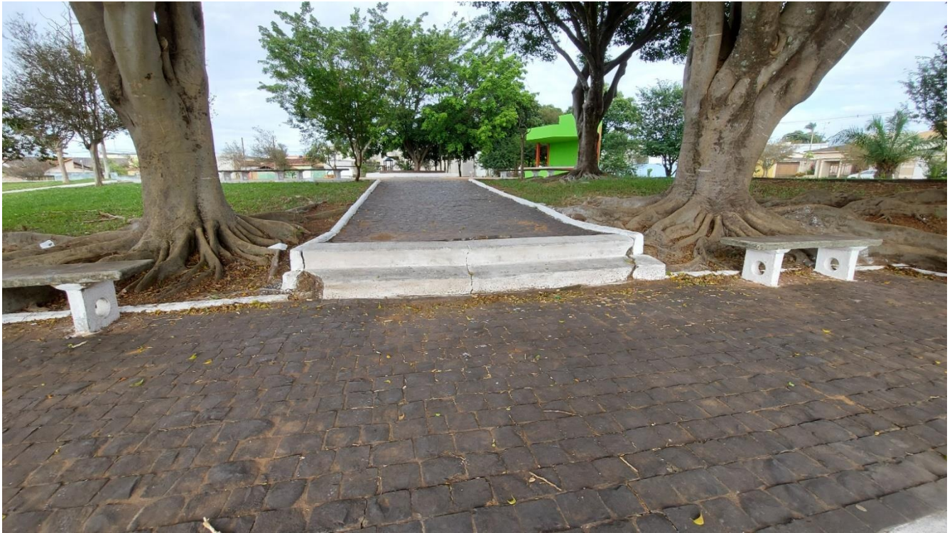
Foto 05: Raízes dos Ficus expostas, danificando a estrutura da Praça Valdomiro Barbosa
